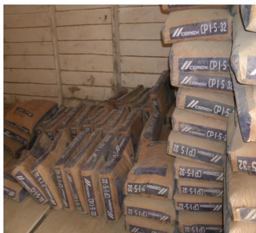
Figura 2 – Incorreto Acondicionamento do cimento
