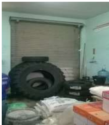
Imagem 3 – defeito na porta de entrada
