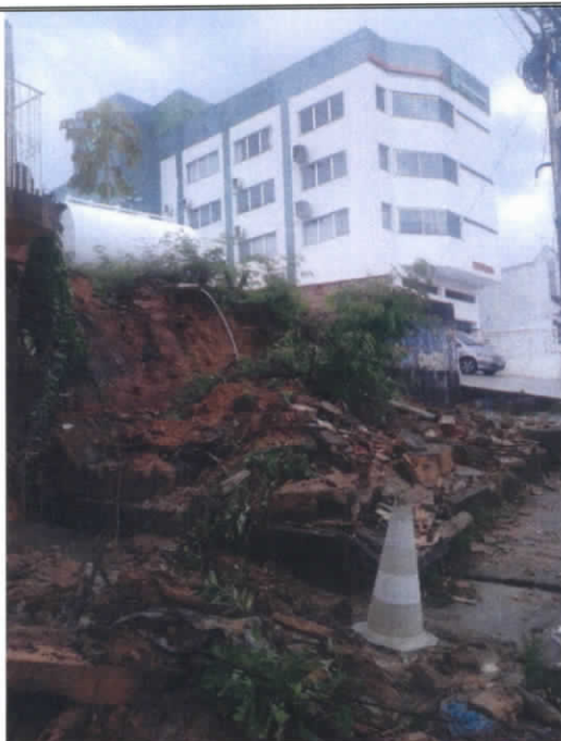
FOTOGRAFIA 2 – Vista do sinistro – Desmoronamento do muro de contenção em uma posição bastante próxima a FOTOGRAFIA 1. Datada de 05 de maio de 2016.
