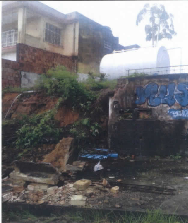
FOTOGRAFIA 5 – Vista frontal da estrutura colapsada, detalhe para a parte do muro existente que também está em crítica situação no que tange segurança do muro.
