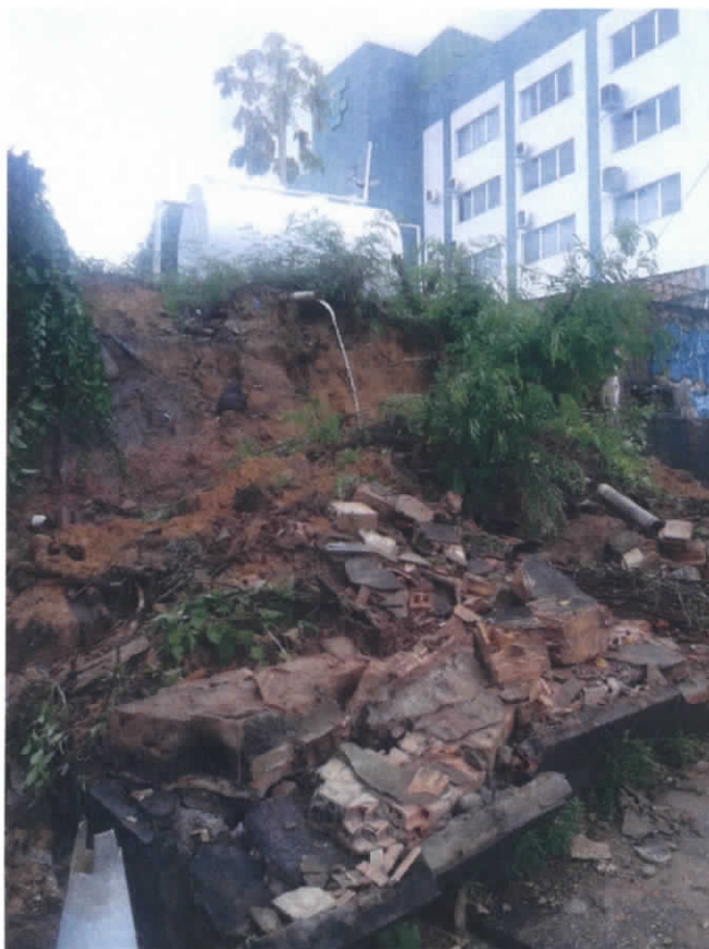
FOTOGRAFIA 4 - Vista frontal da estrutura colapsada, detalhe para os danos ao piso da calçada e da grande proximidade da ETE do local.
