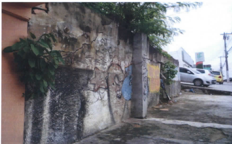
FOTOGRAFIA 1 - Vista da face norte do muro externo frontal, detalhe para as grandes trincas existentes neste elemento construtivo. Datado de 21 de fevereiro de 2016.
