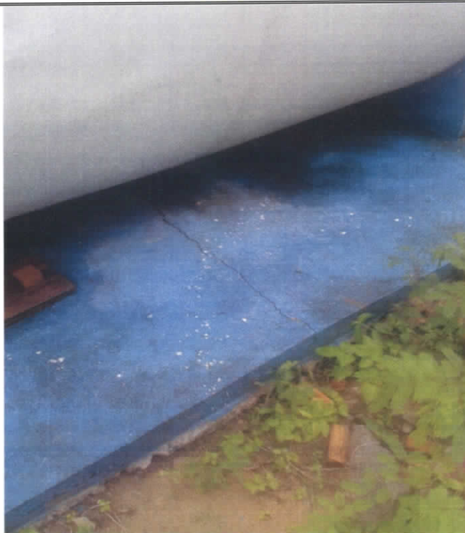
FOTOGRAFIA 7 - Vista detalhada de fissuração da base de suporte da Estação de Tratamento de Esgoto.
