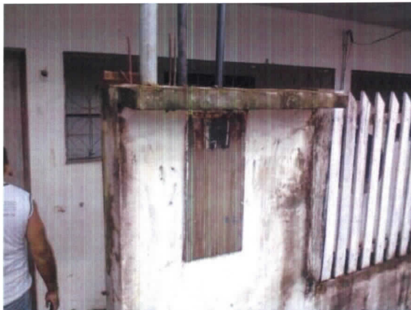
Fotografia 8 – Vista da fachada do Campus com a rede de entrada de energia da edificação sem condições de utilização.
