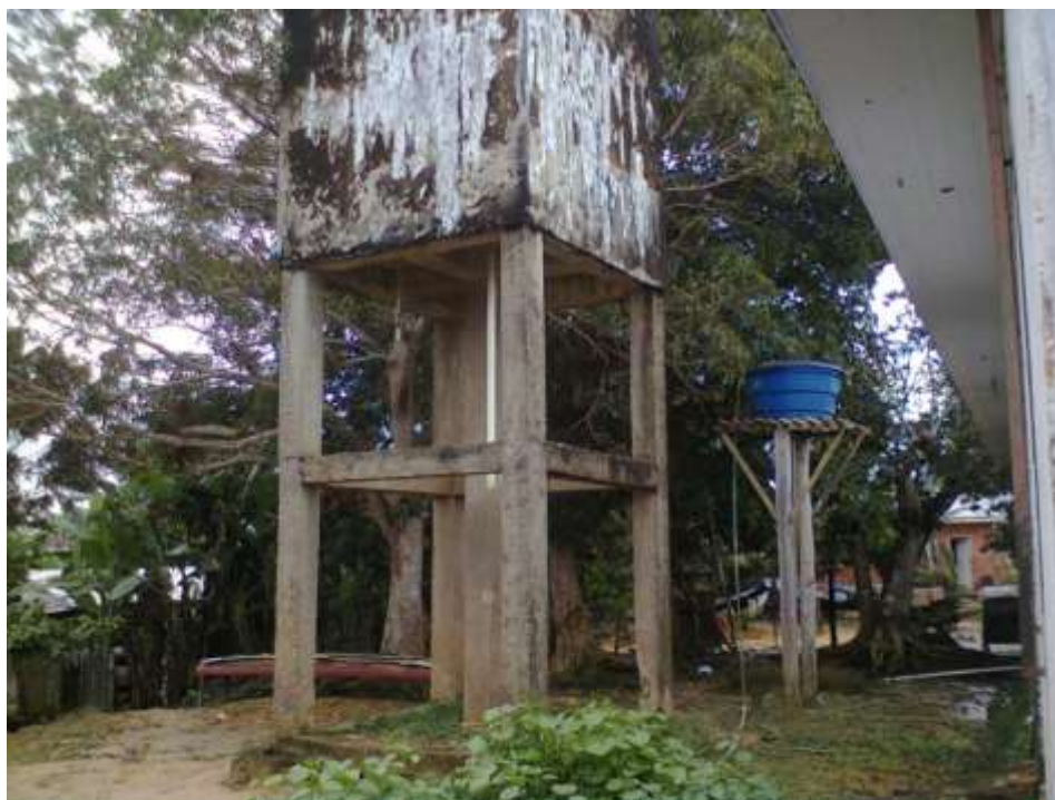
Fotografia 2 – Vista dos fundos da edificação. Nesta área será executada a ampliação da edificação, devendo ser removido o reservatório de concreto armado e o de fibra de vidro.
