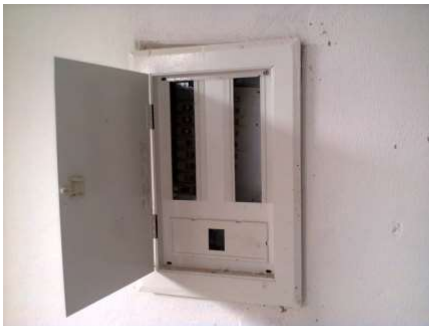
Fotografia 15 – Os quadros existentes foram saqueados durante o abandono da edificação. As instalações elétricas deverão ser totalmente revistas.
