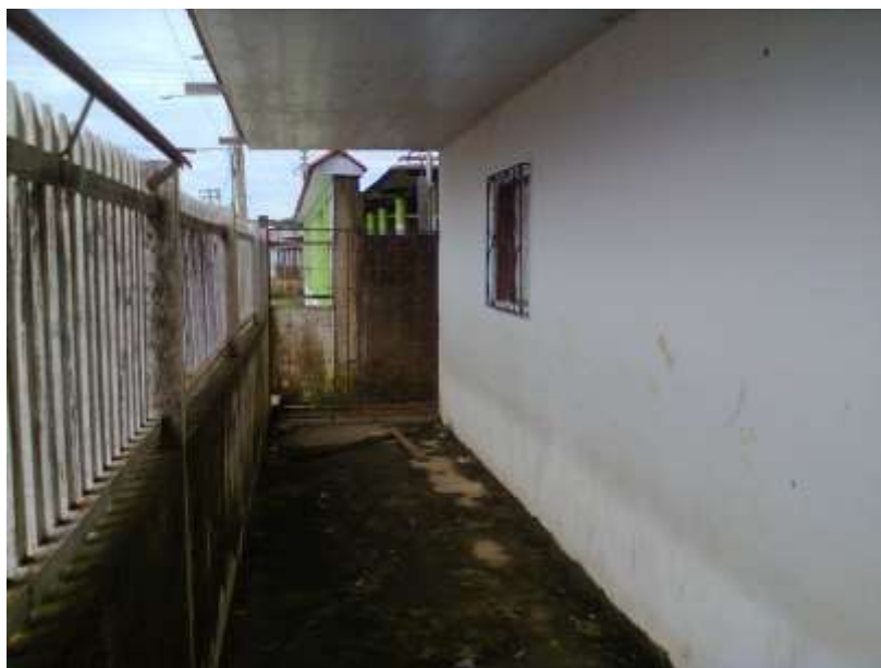
Fotografia 9 – Vista da entrada da edificação. Detalhe para o piso que constantemente tem acúmulo de água devido ao desnível com a via principal.
