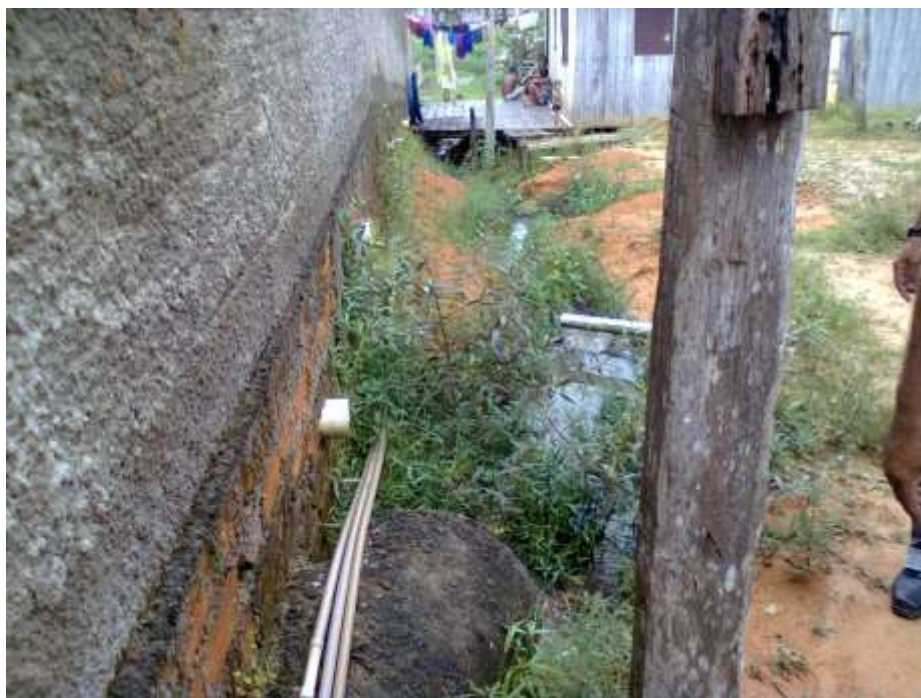
Fotografia 6 – Vista da tubulação de Esgoto / drenagem nos fundos do Campus. Este elemento será corrigido na reforma.
