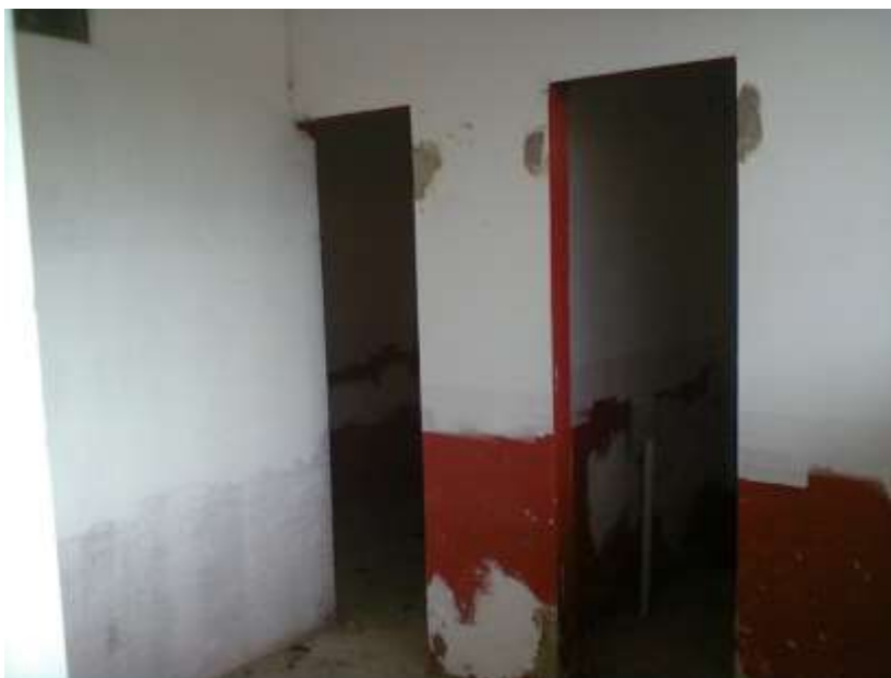
Fotografia 10 – Vista dos banheiros existentes na edificação, estes deverão ser utilizados pelos operários da obra.
