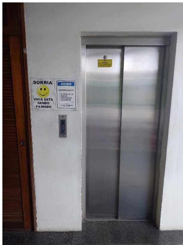
Figura 4 - Elevador localizado no CDI (Centro de Documentação e Informação).
