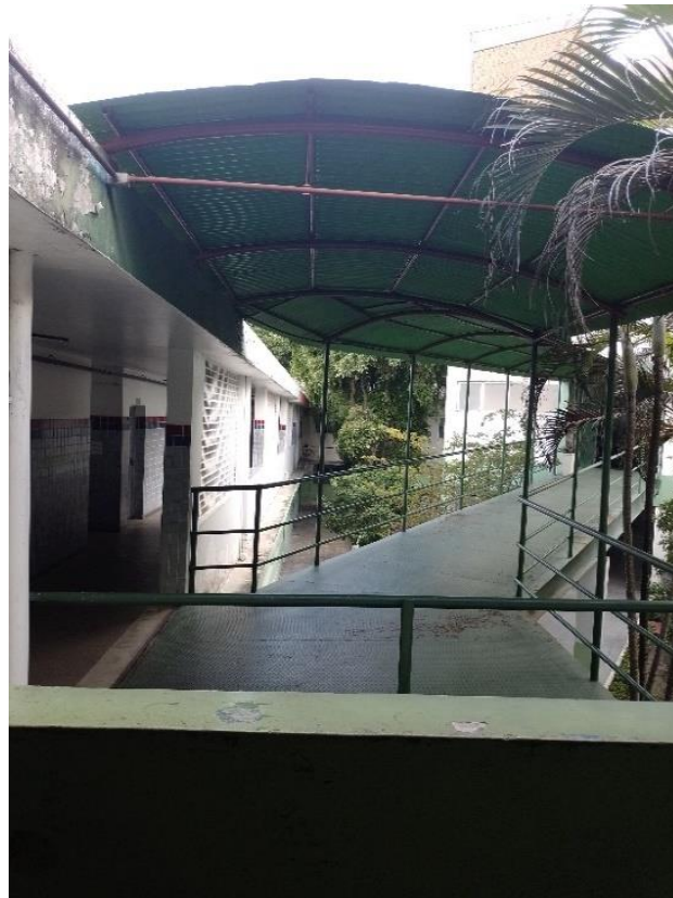
Figura 3 - Rampa de ligação entre o bloco de salas de aula e o 1º pavimento do CDI.
