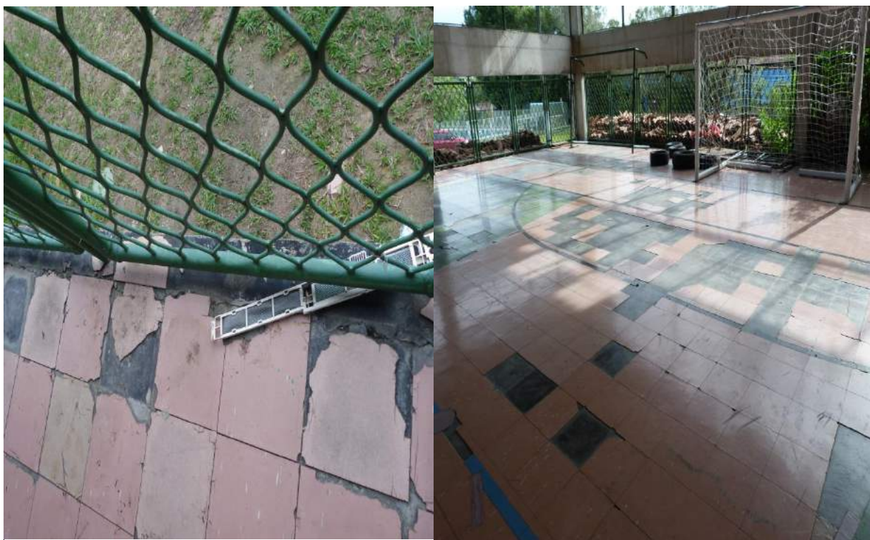
Figura 3: Estado Atual do Piso do Ginásio Poliesportivo Campus CMDI.
