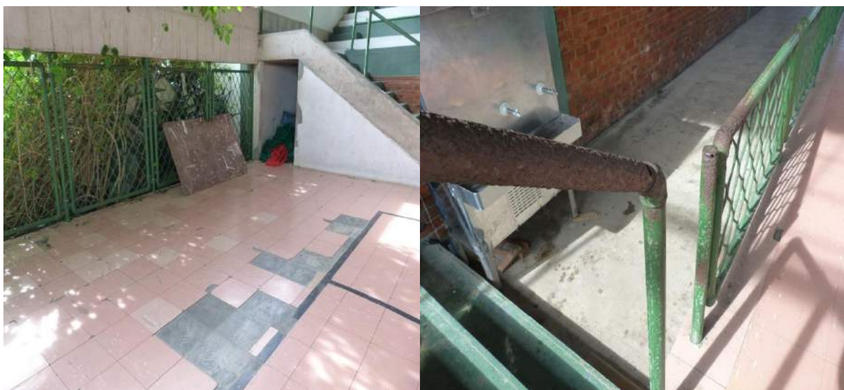
Figura 4: Grades comprometidas - Ginásio Poliesportivo Campus CMDI.
